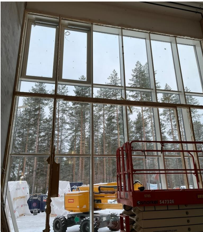
Kuva 2 2.krs Lasiakun edestä purettu eristeseinä
